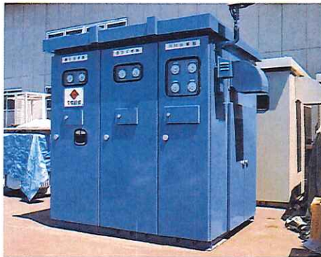
▲制御システムを内蔵した受変電盤
