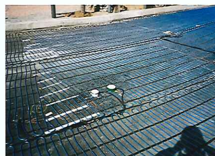
センサ取付状況
